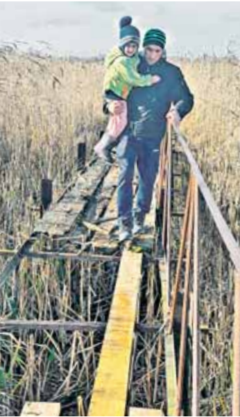
❖ Таким был мост до ремонта.
